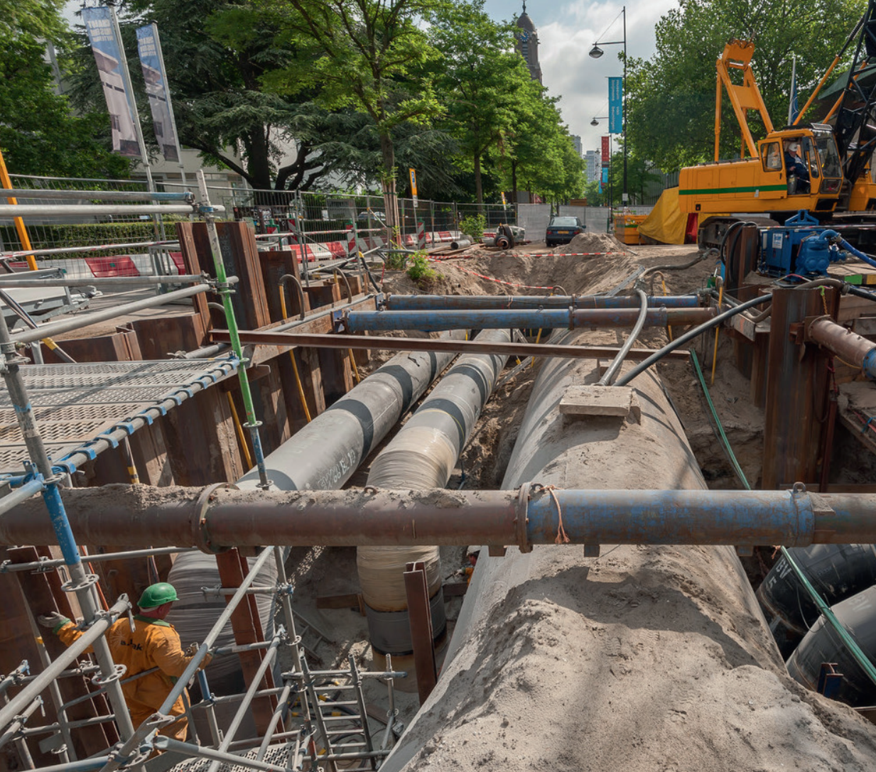
Groot riool waar stadsverwarmingsbuizen onderdoor steken. BRON GEMEENTE ROTTERDAM
